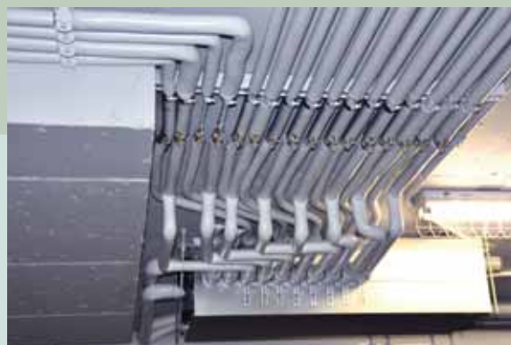
Cette boîte de répartition desservant 8 logements permet de récupérer l'énergie et de la répartir pour des besoins simultanés de chauffage et de climatisation.
