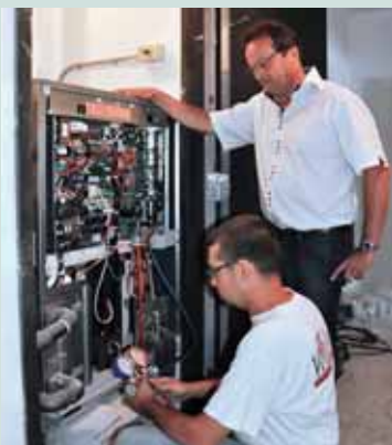
Yves Rousseau (debout), président de Ventilex, vérifie la mise en service d'un des condenseurs d'étage installé dans un renforcement parfaitement insonorisé.
