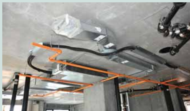
Aperçu des réseaux terminaux de ventilation et de chauffage/climatisation. Toutes les extrémités sont scellées jusqu'à la fin des travaux pour éviter toute infiltration de poussière ou de matières indésirables.
