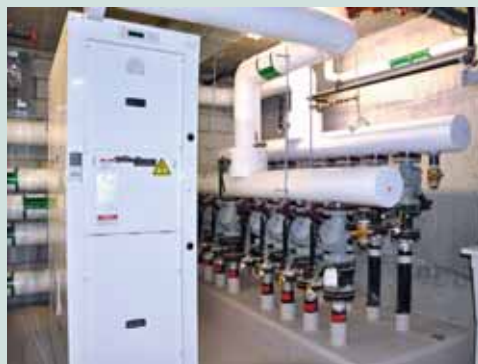
L'une des 3 thermopompes géothermiques près des collecteurs d'alimentation et de retour des 32 puits.
