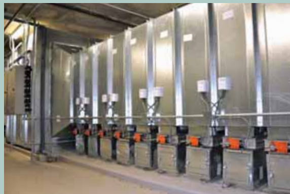
Toute la chaleur évacuée des sècheuses et des corridors est captée par ces conduits de ventilation et récupérée à l'aide d'un échangeur de chaleur pour préchauffer l'air frais.
