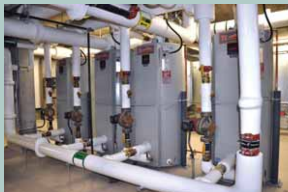
4 chauffe-eau Thermo 2000 Turbomax, alimentés par 2 chaudières Camus Dynaflame à haute efficacité, suffisent à assurer le chauffage de l'eau chaude sanitaire.
