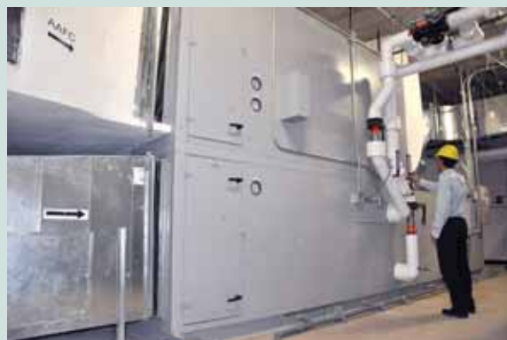
Un technicien vérifie la pression dans la centrale de traitement d'air qui alimente tout le bâtiment en air neuf.
